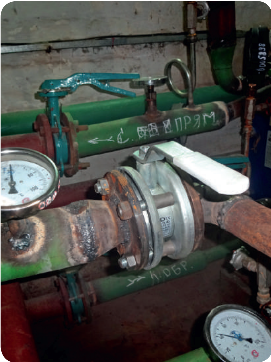
ТЕПЛОПУНКТ (ОБВЯЗКА ТЕПЛООБМЕННИКА)
