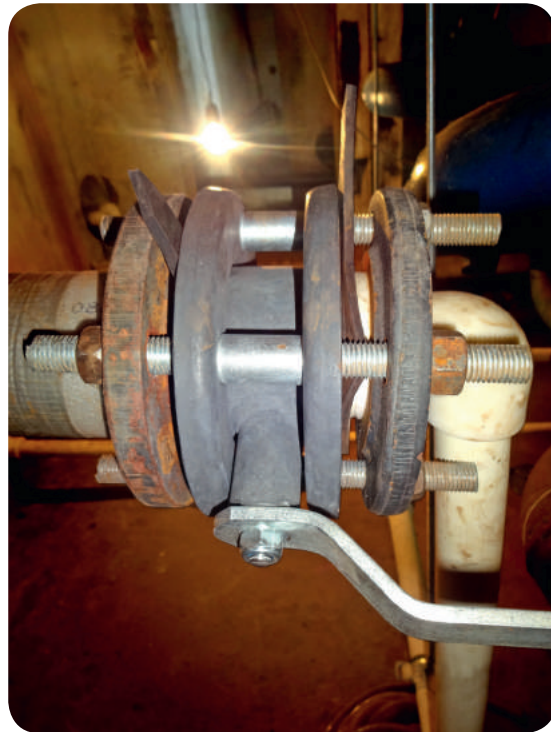
ПОДВАЛ ЖИЛОГО ДОМА (КОНТУР ГВС)
